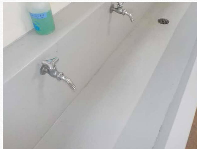
廊下の流し(蛇口)
